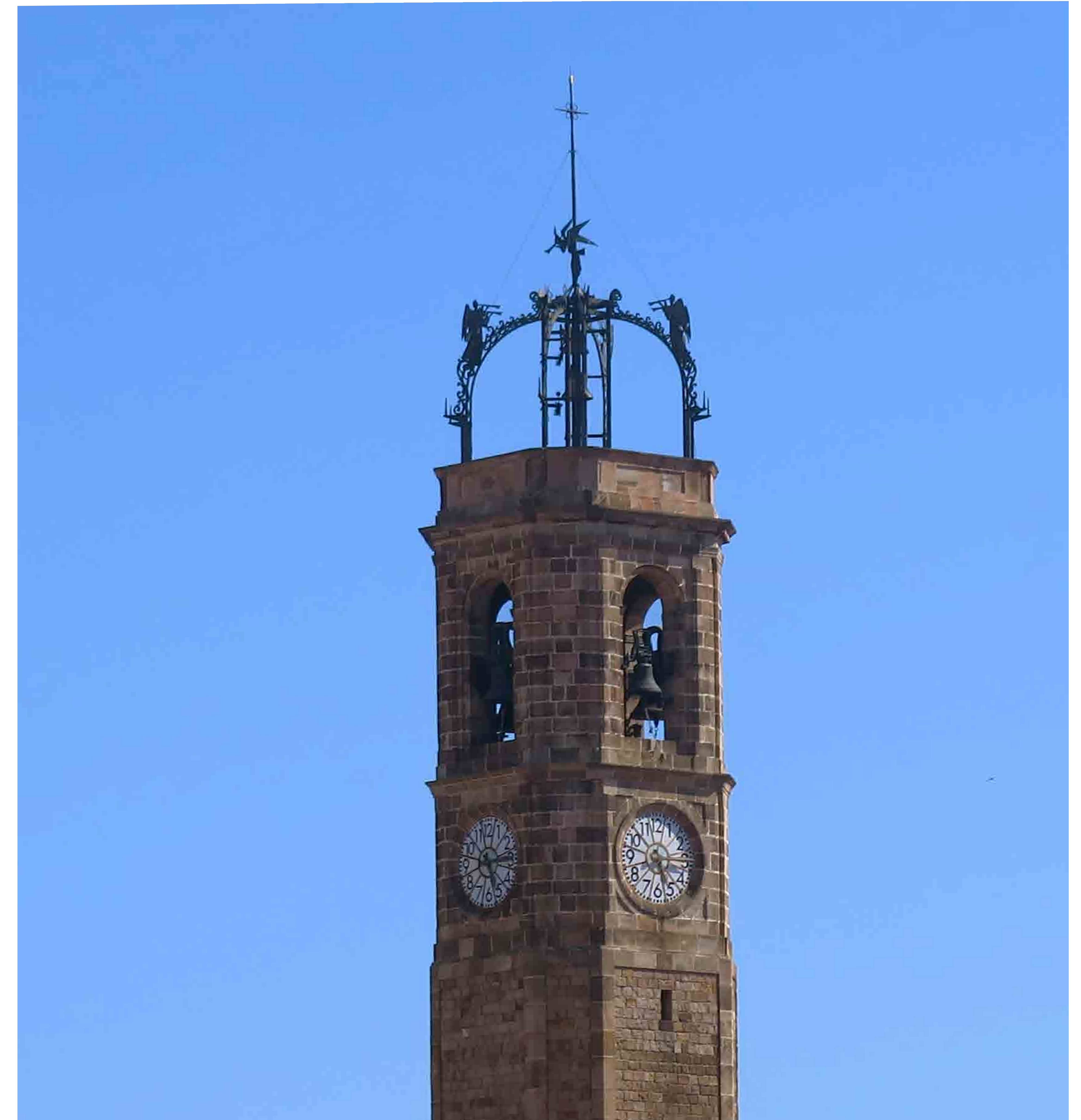
7. Campanar de Santa Maria en l'actualitat, amb les 4 campanes litúrgiques en la sala de campanes, i les dues horàries en l'estructura metàl·lica del terrat del campanar, ben protegides per uns quants àngels trompeters.
